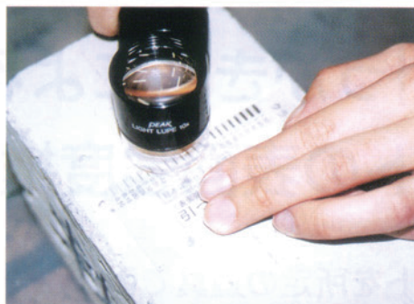
写真-4 傷幅の測定
